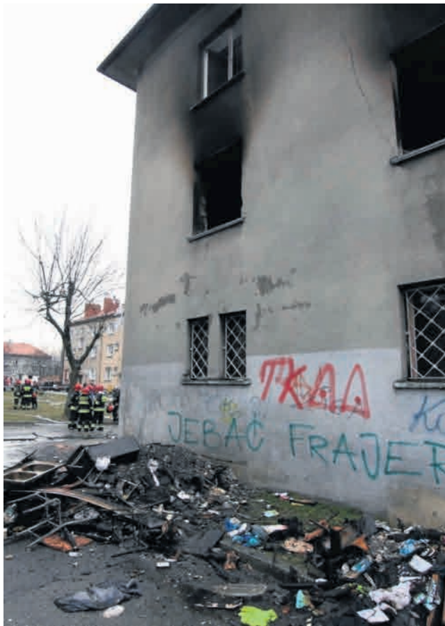
► Mieszkanie, w którym doszło do eksplozji, zostało całkowicie zniszczone. Reszta budynku ocalała, ale będą niezbędne naprawy
